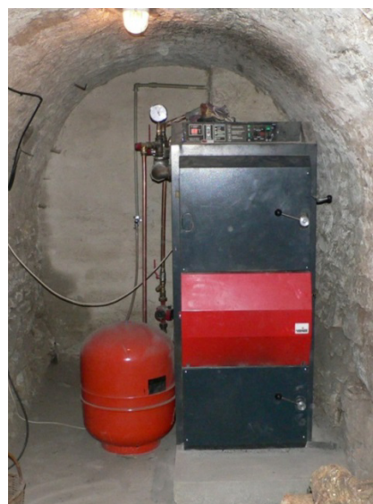
Kotel na kusové dřevo bez akumulací nádrže není vhodné řešení
