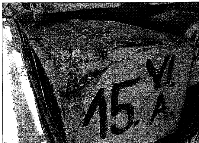
Obr. 8 Typické poškození tvarovaného kamene z hoříckého pískovce vsazeného do vrchu zábradlí mostu v roce 1892 klenby VI s průběžnými trhlinami podél stran (kvádr z klenby VI byl vyřazen a nahrazen kvádrem z kocbeřského pískovce).
