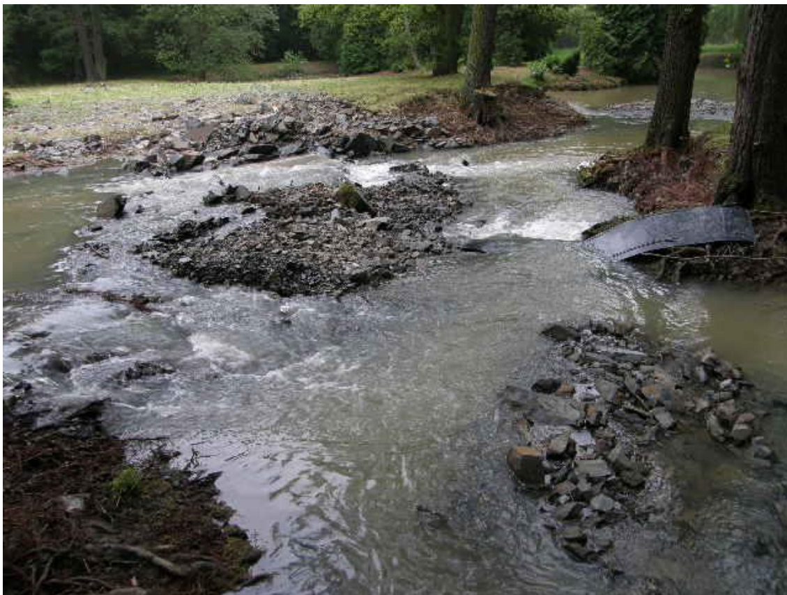
Obr. 91: Partie pod bezpečnostním rybníkem Bořín – stav po povodni v červnu 2013
