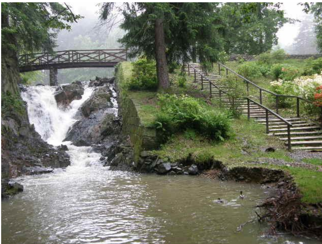
Obr. 87: Partie pod bezpečnostním rybníkem Bořín – stav po povodni v červnu 2013
