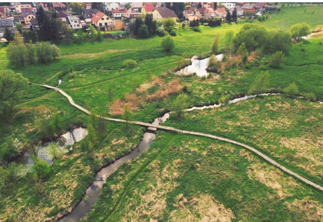
Suchý poldr „Čihadla“. Revitalizace krajiny spočívala v zasypání starých napřímených koryt a nahrazení novými, přírodě blízkými, mělkými, meandrujícími toky. Vznikly malé rybníky, jejichž břehy byly upraveny tak, aby umožňovaly co nejlepší rozvoj fauny a flóry. FOTO: WWW.PRAHA-PRIRODA.CZ, OCP MHMP
