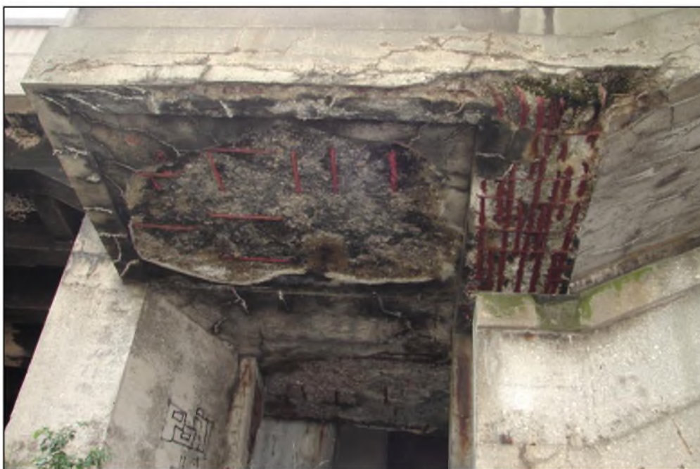
Obr. 16: Schodiště, oslabení výztuže a hloubková degradace betonu - havarijný stav
