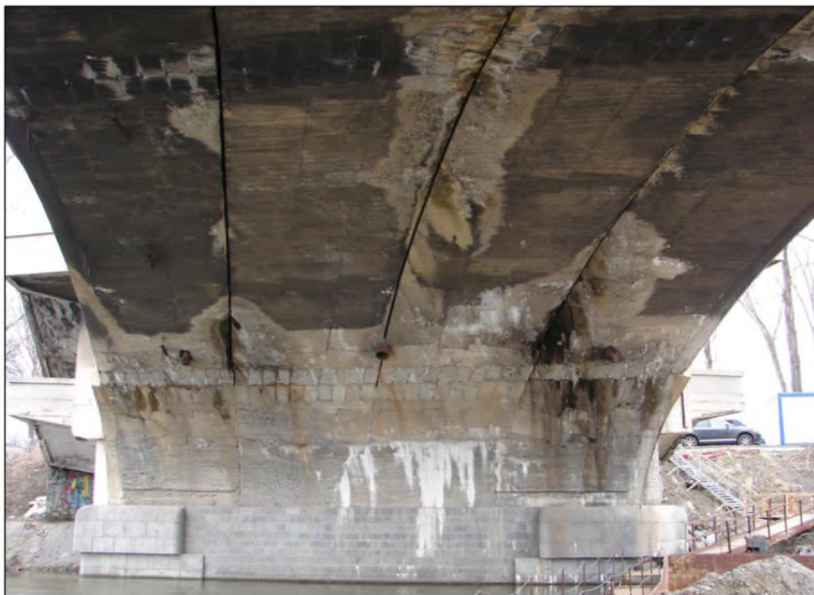
Obr. 10: Degradace betonu klenby a opěry v důsledku průsaků a zatékání v kombinaci s účinky mrazu
