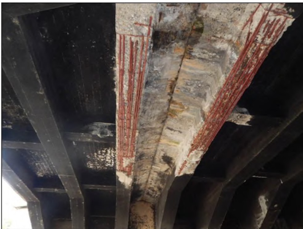
Obr. 18: Rámová konstrukce; rám Libeň, část C v oblasti podélné dilatační spáry; oslabení výztuže a hloubková degradace betonu - havarijný stav
