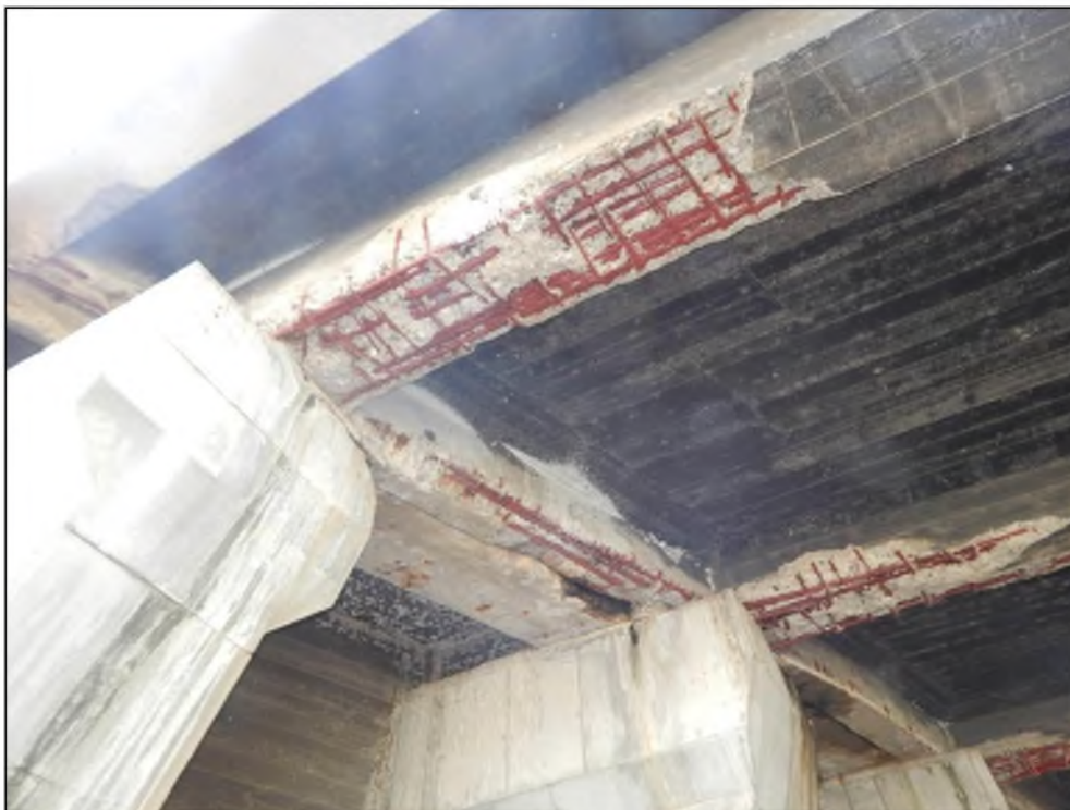
Obr. 17: Rámová konstrukce; rám Holešovice, část I-VI v oblasti kloubu; oslabení výztuže a hloubková degradace betonu - havarijný stav
