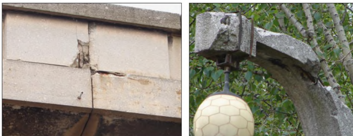
Obr. 12 a 13: Poškození zábradlí a konzoly ve vrcholu klenby zejména v důsledku dilatačních pohybů a pylonu veřejného osvětlení (kandelábru) v důsledku koroze výztuže a klimatických vlivů
