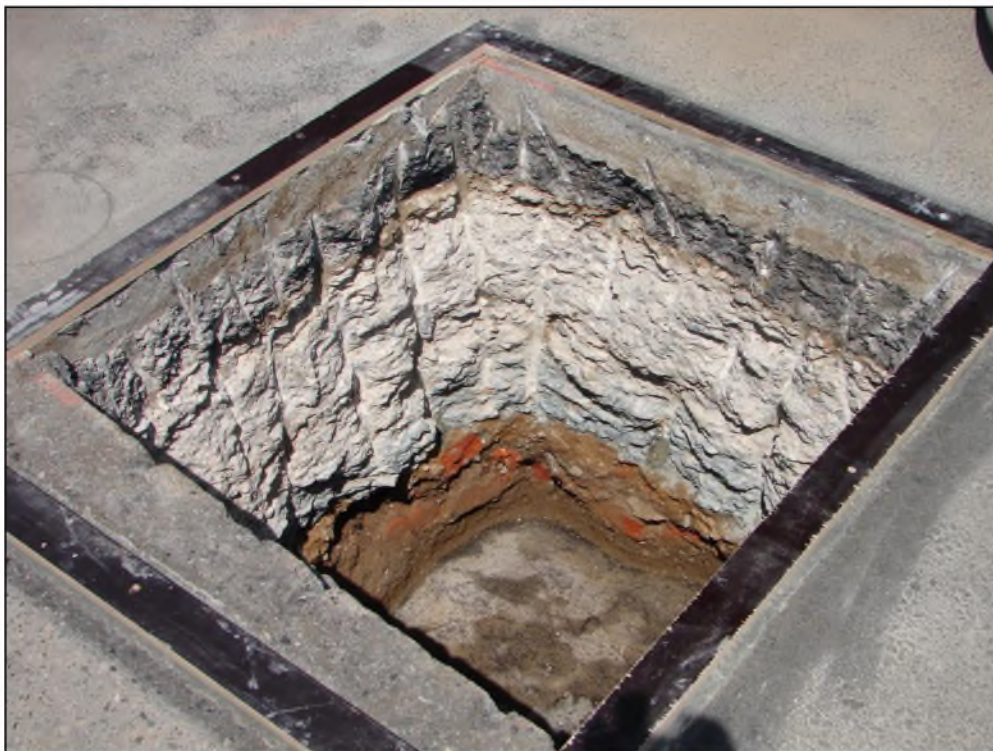
Obr. 15: Souvrství betonů pod vozovkou klenbového mostu a násyp štěrkopísku a stavební suti
